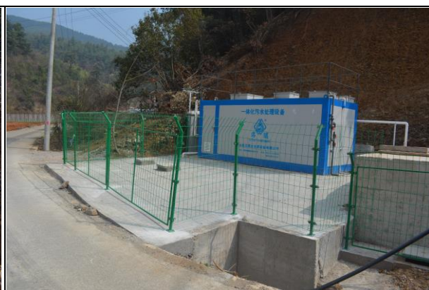
一体化污水处理设备（2023 年 6 月）
