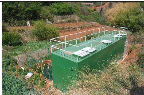
一体化污水处理站（2023 年 8 月）
