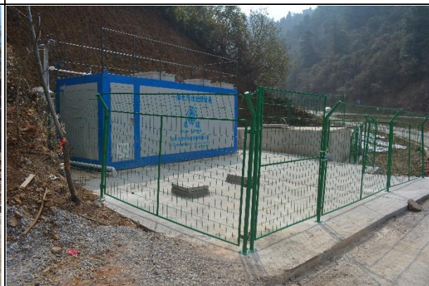
一体化污水处理设备（2023 年 6 月）
