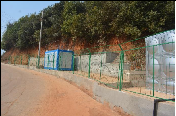
一体化污水处理设备（2023 年 6 月）
