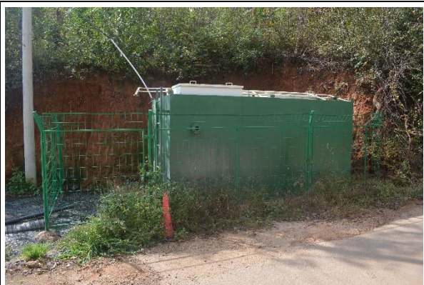
一体化污水处理站（2023 年 9 月）
