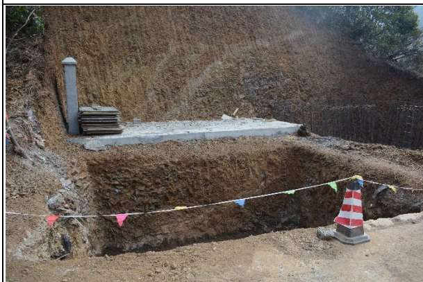
一体化污水处理设备（2022 年 12 月）
