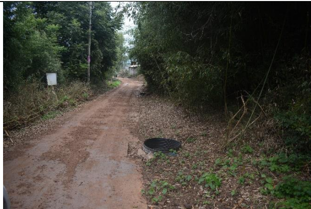
污水管检查井（2022 年 9 月）
