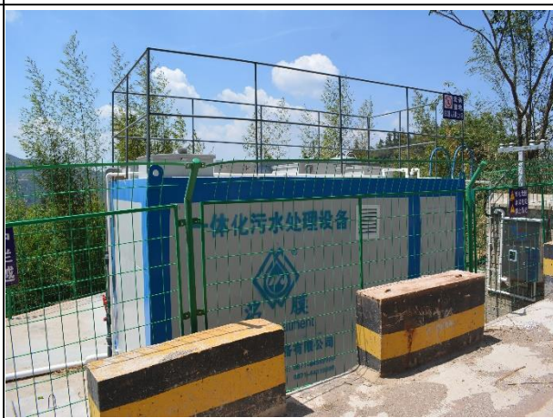
一体化污水处理设备（2023年6月）
