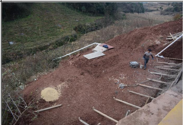
一体化污水处理站（2022 年 12 月）
