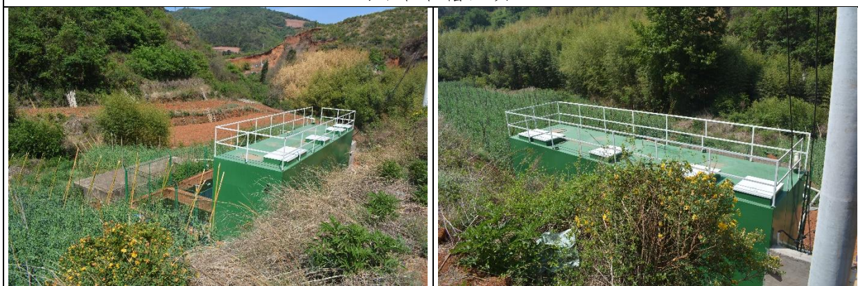
一体化污水处理站
