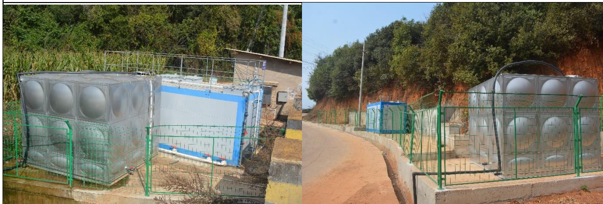
图 1-4 项目区一体化污水处理站现状情况
