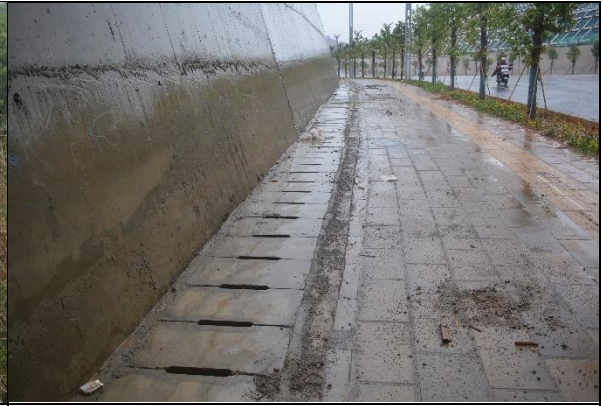
项目区透水铺装及雨水管现状
