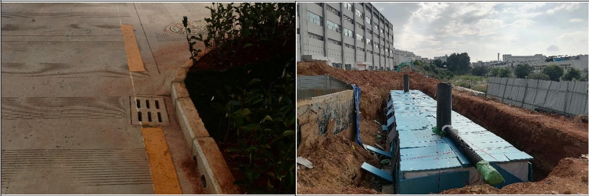
图 3-2 已实施排水沟
