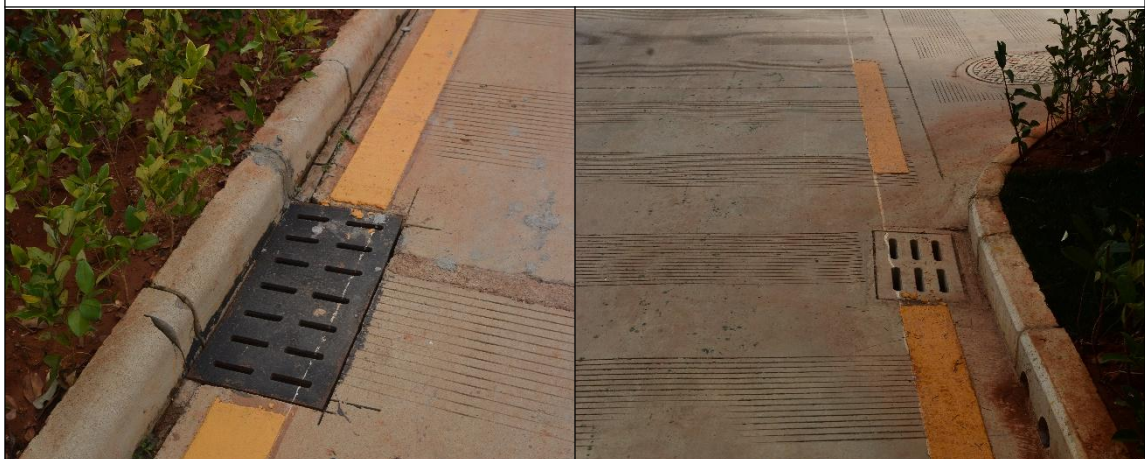
图 8 项目区雨水口
