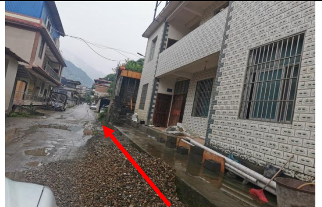
木古甲公路段 (K1+578) 现状
