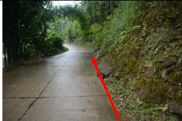
木古甲公路段 (K1+322) 现状
