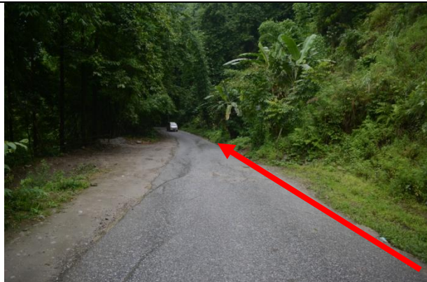
木古甲公路段（K0+369）现状
