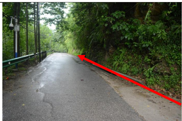
木古甲公路段（K0+072）现状
