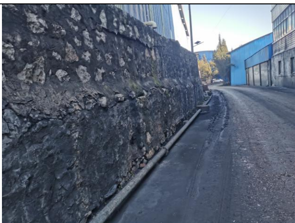
挡土墙现状图
