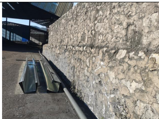
挡土墙现状图
